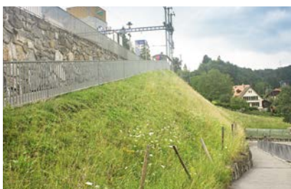
Protection contre l'érosion remblai de voie ferrée
