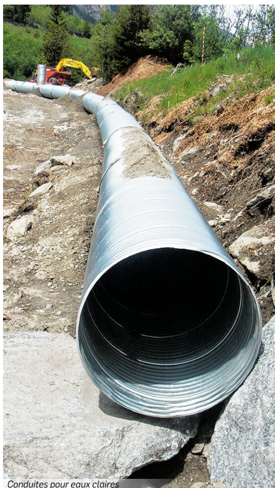
Conduites pour eaux claires
