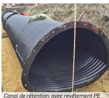
Canal de rétention, avec revêtement PE
