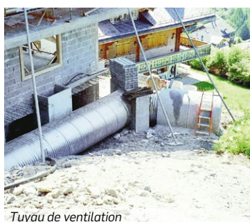
Tuyau de ventilation
