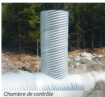
Chambre de contrôle
