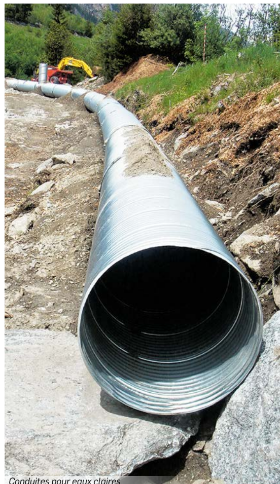
Conduites pour eaux claires
