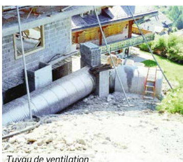
Tuyau de ventilation
